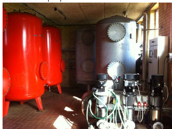
Foto af rentvandspumper
